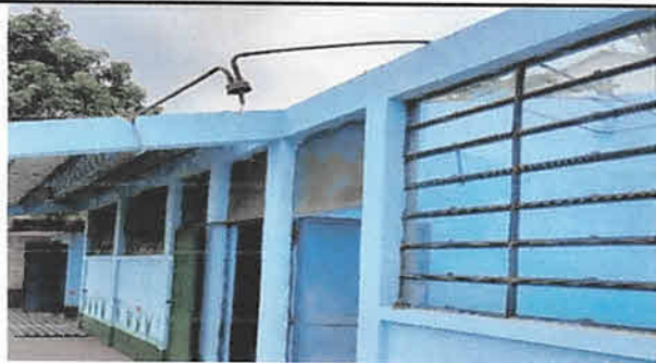
Foto 3: Mantenimiento del sistema eléctrico.
